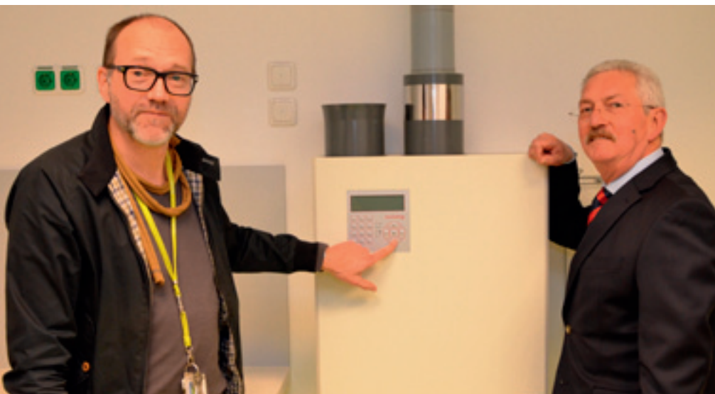
Martin Sonnenberg und Hans-Peter Beuthien an der Station der neuen Rohrpostanlage
